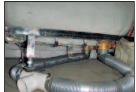
Spazio sottostante la vasca e raccordo a T. Space under the bathtub and T-pipe fitting.
